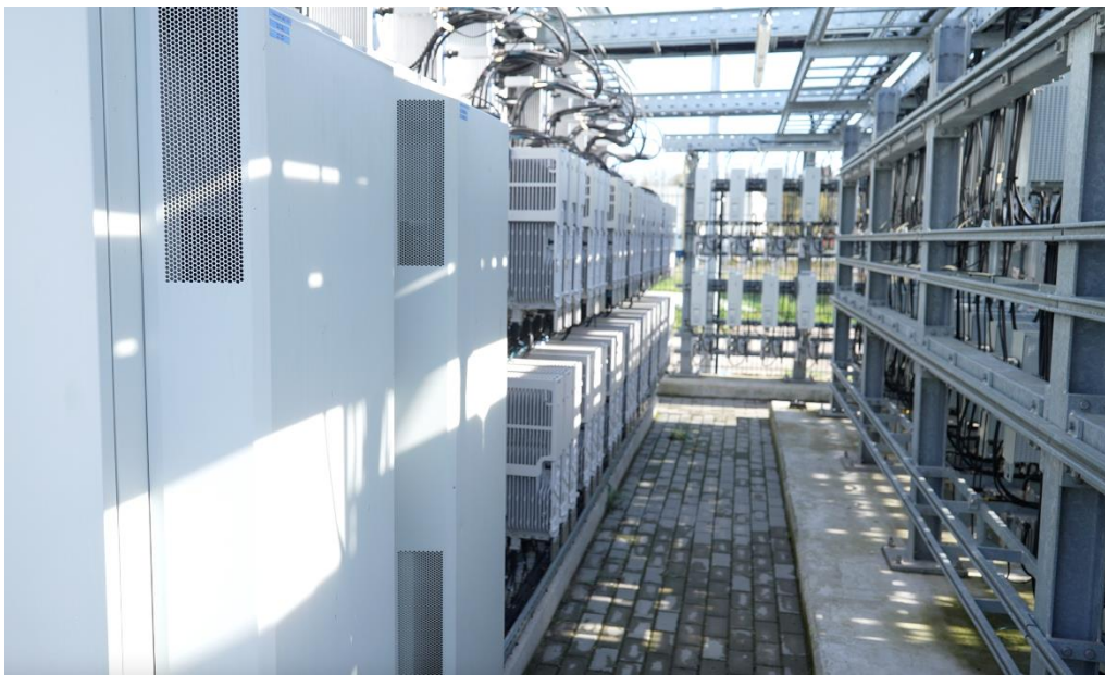
„BTS-Hotel“ für die Versorgung der U-Bahn Bild: O2 Telefónica
